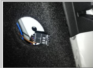
3.13 接尾门信号：如图原车门锁信号插头，用我司转接插头对插安装
